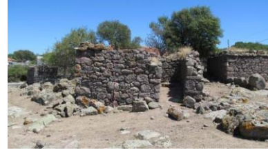
Nene Evi 6 Kullanım Durumu: Terkedilmiş / Sağlamlık Durumu: Harap
