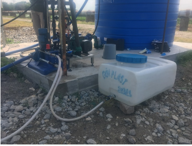
Şekil 2. Hidrojen peroksit uygulaması için kullanılan pompa ve depo.
