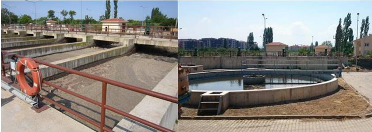
Şekil 2. Kepez Atık Su Arıtma Tesisleri
