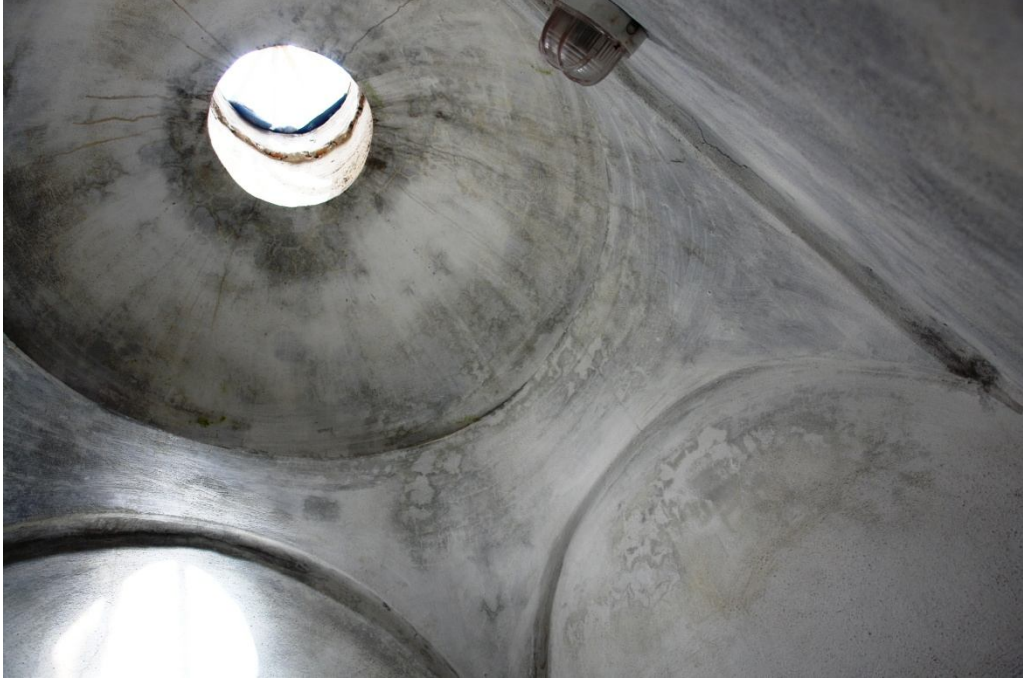
Fotoğraf 2.161: Erzurum Gümrük (Hacı Derviş) Külliyesi hamam tuvalet mekanı örtü sistemi (Vakıflar Genel Müdürlüğü arşivi 250001033-FT004-2009'nolu dosya)
