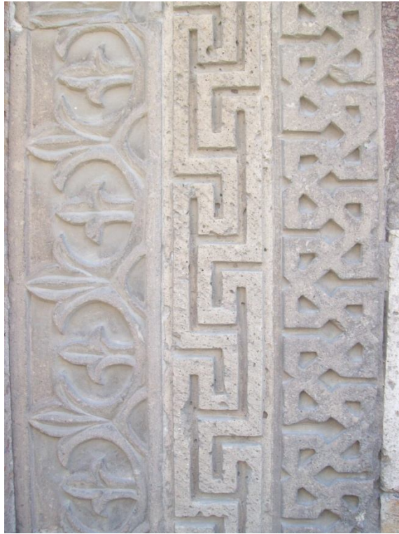
Fotoğraf 2.368: Nevşehir Damat İbrahim Paşa cami avlusu güney duvarındaki çeşme bordür süsleme detayı
