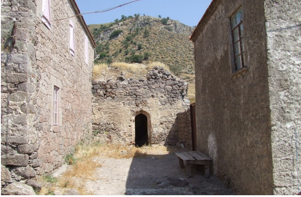
Fotoğraf 2.807: Çanakkale Babakale Çifte Hamam erkekler bölümü soyunmalık mekanının durumu
