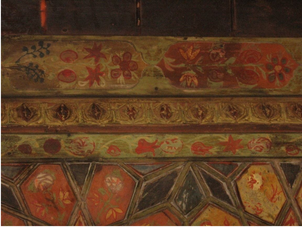
Fotoğraf 2.703: Amasya Merzifon Çay (Aşçı Hüseyin Ağa) Cami harim tavanı süsleme detayı
