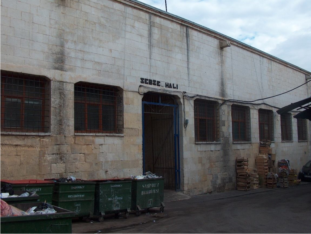
Fotoğraf 2.228: Gaziantep Hüseyin Paşa Arastası (Zincirli Bedesten) kısa kenar batı giriş kapısı
