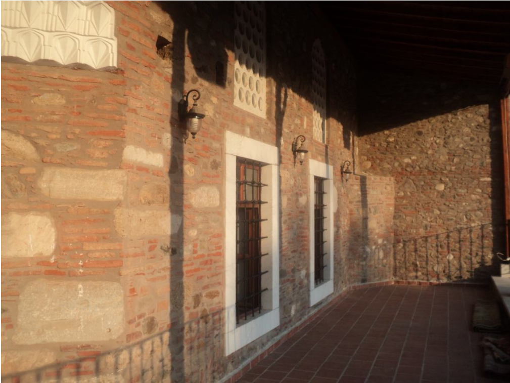
Fotoğraf 2.4: Aydın Nasuh Paşa Külliyesi derashane-mescid batı cephe.
