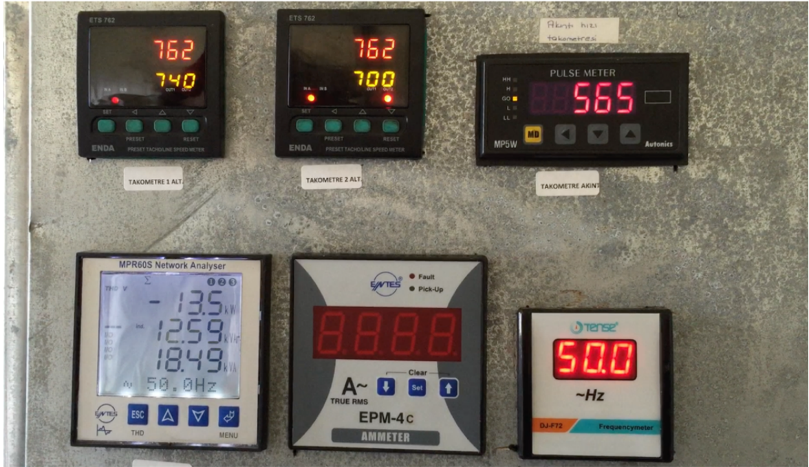
Şekil 16. Çalışma sahasındaki türbinin kontrol panosu (Özgün)
