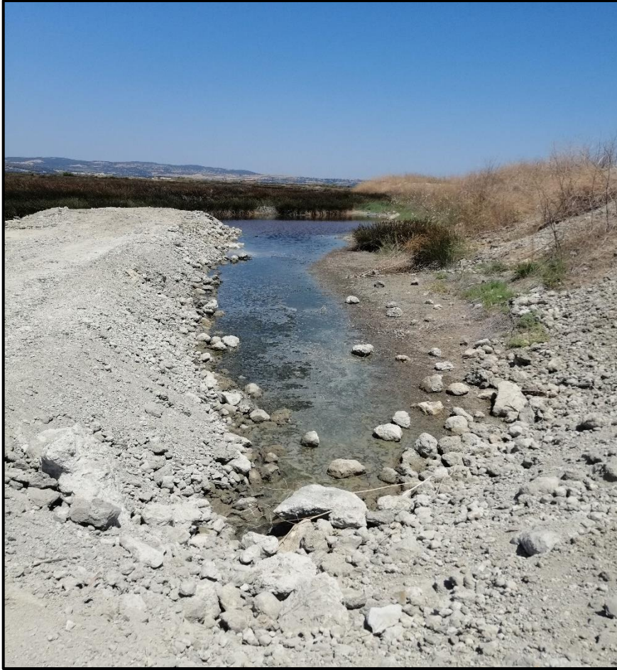
Şekil 8. Çoraklık Azmak inşaat molozları ile sulak alana müdahale
