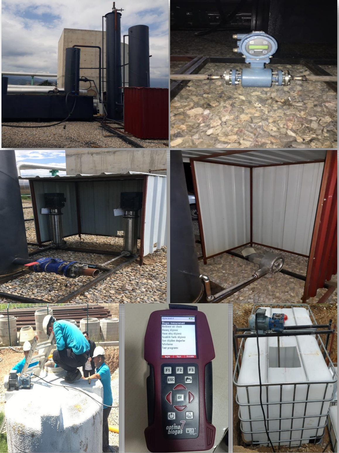
Şekil 7. Tesis içerisinde ekipmanlara ait görseller.
