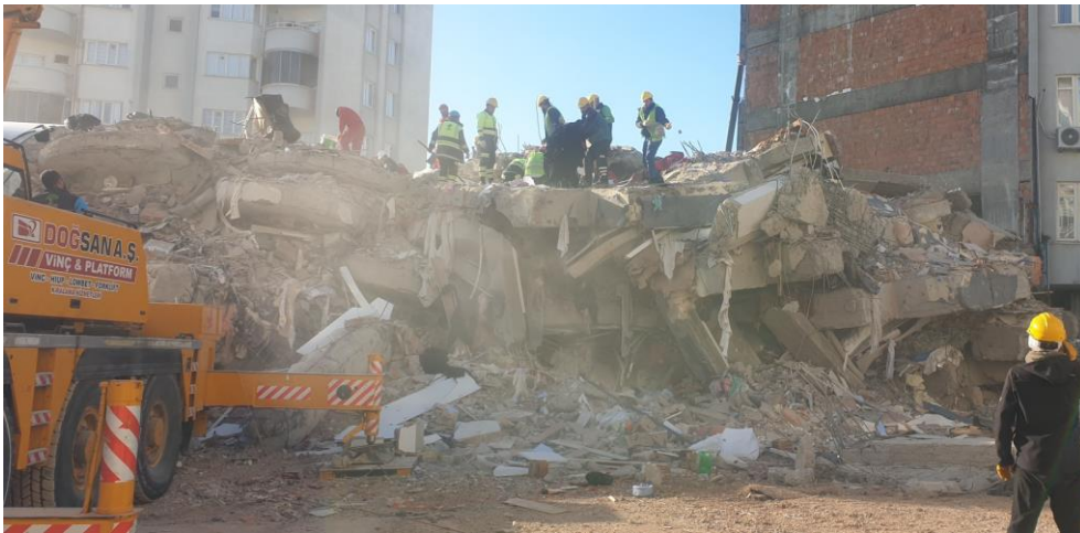
Şekil 2. 6 Şubat 2023 depremlerinde Gaziantep' te çökmüş bir bina. (Mertol vd., 2023)
