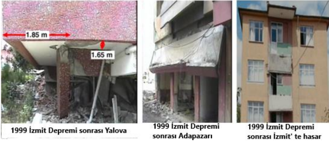
Şekil 6. 1999 İzmit Depremi' nde ağır çıkmalar sebebiyle hasar gören binalar.
