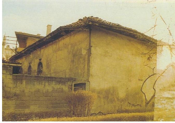
Resim 12: Semahanenin onarım öncesi durumu (Haksever, 2017,345)
